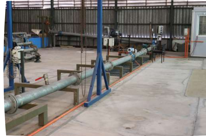
Banco de calibración de ducto cerrado.
